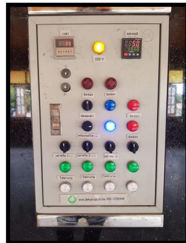
ชุดตู้คอนโทรลควบคุม
