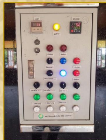
ชุดตู้คอนโทรลควบคุม
