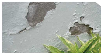
สีลอกล่อน (Peeling)
